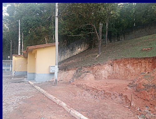
Novo local da Cabine Primária de Energia
